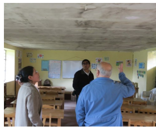
.....mit der durchgeschimmelten Decke
