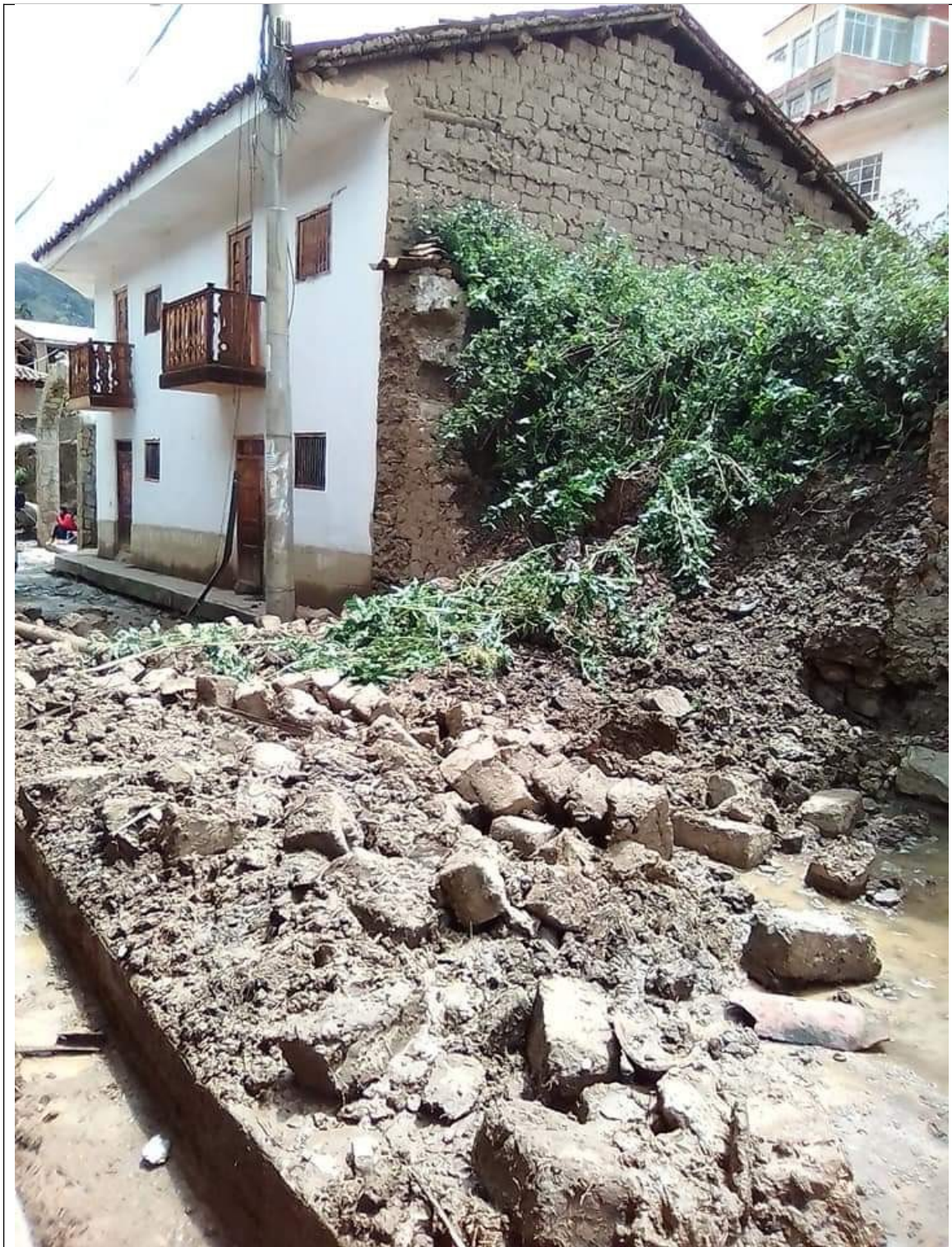
Jr. Huamachuco se cayo toda la pared
